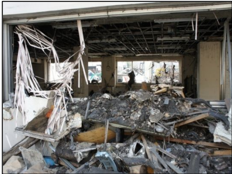
釜石市(浸水したケーブルテレビの社屋)
