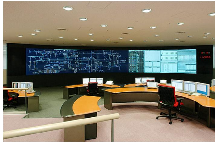
電力系統監視制御システム
